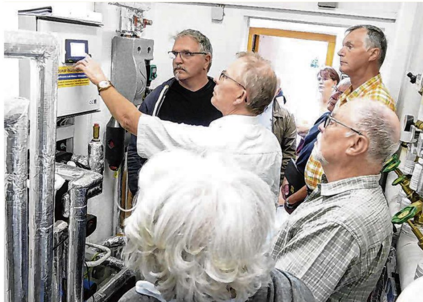
Axel Isert stand in seinem Anwesen in der Ergersheimer Straße für Fragen rund um die Wärmepumpe zur Verfügung. Er führte, ebenso wie Installateur Hans-Peter Höcker, durch die Technikräume. Foto: Helmut Meixner
